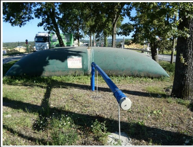
Réserve incendie (120 m 3 ).
