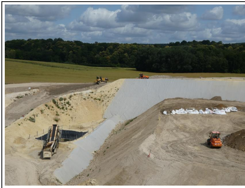
Vue de la digue technique de l'ISDND au Nord du site (juin 2023).
