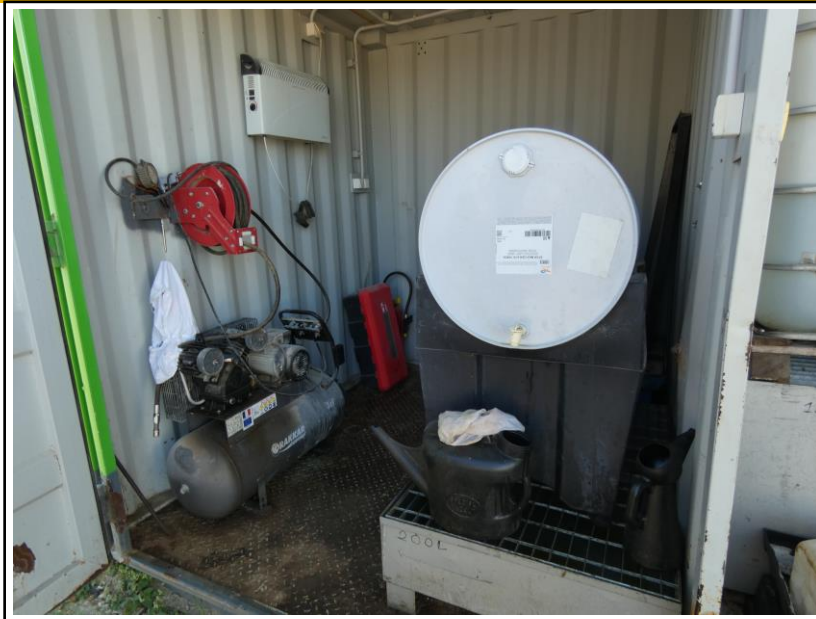
Stockage du fût d'huiles neuves sur rétention étanche, à l'intérieur d'un local technique (septembre 2023).
